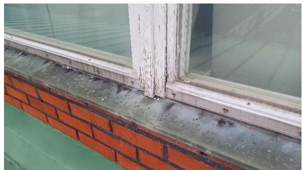
Kuva 38. Liikuntasalin ruokalan puoleiset ikkunat teknisen käyttöiän ohittaneita.
