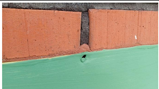
Kuva 40. Pellityksen ja sauman massauksissa on epätiiveyksiä.
