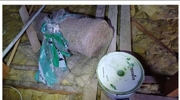
Kuva 58. Liikuntasalin yläpuolisessa yläpohjatilassa sinne kuulumatonta rakennusjätettä
