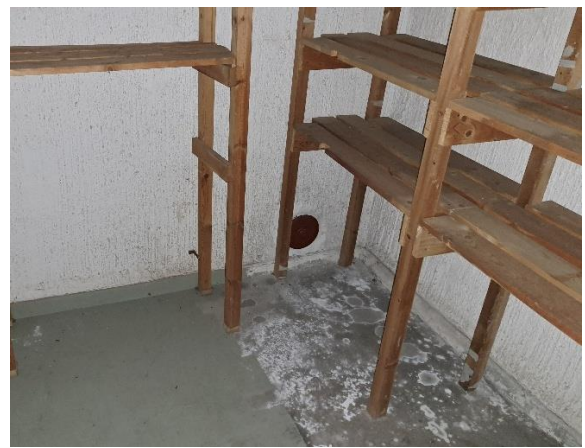
Kuva 19. Matalan osan kellaritiloissa kosteuden aiheuttamaa vesijälkeä. Mp- seinissä mikrobivaurioita.
