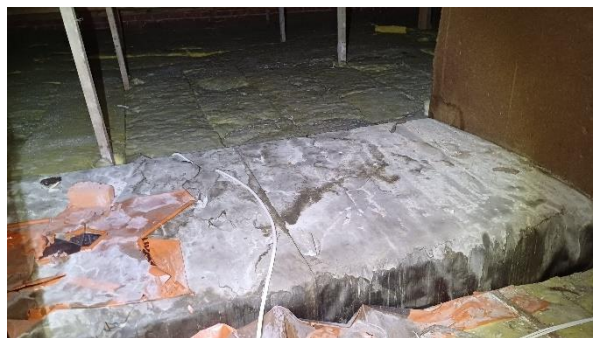
Kuva 60. Liikuntasalin yläpuolisen yläpohjatilan rakenteissa silminnähtäviä kosteusvauriojälkiä
