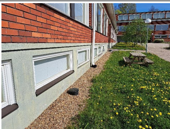
Kuva 11. Etupihan maanpaineeseinäosuudella on salaojan tarkastuskaivot (2 kpl).
