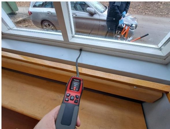
Kuva 45. Aulan ikkunapenkistä havaittiin ilmavuotoa sisäilmaan.
