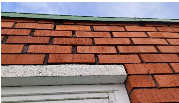
Kuva 37. Liikuntasalin ruokalan puoleiset ulkoseinän tiilisäumat huonokuntoisia.
