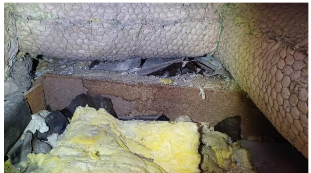
Kuva 56. Kuvaamataidonluokan yläpuolisessa yläpohjatilassa silmännähtäviä kosteusvauriojälkiä sekä yläpohjatilaan kuulumatonta rakennusjätettä
