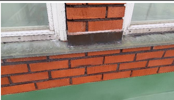
Kuva 39. Liikuntasalin ruokalan puoleiset ulkoseinän tiilisäumat huonokuntoisia.
