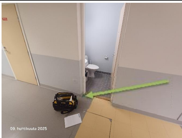
Kuva 27. Viiltomittauksen perusteella opettajien huoneen luona olevan käytävän pinnoitteen alla kosteutta.
