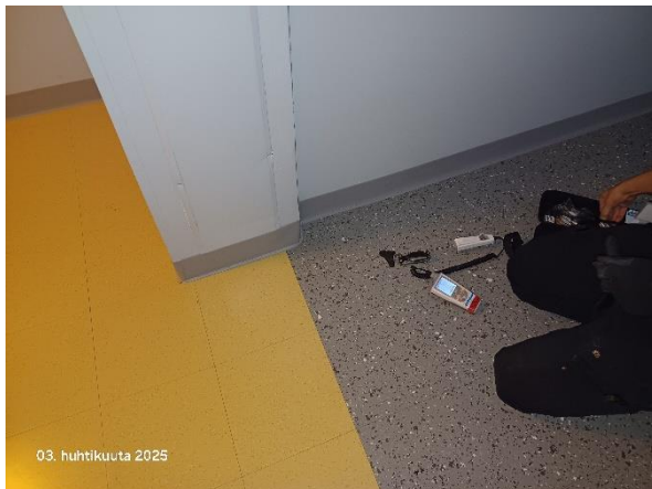
Kuva 25. Matalan osan käytävä, viiltokosteusmittaus pinnoitteen alta.
