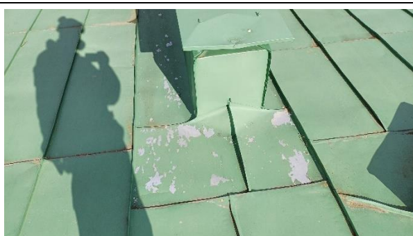
Kuva 54. Konesaumattun peltikatteen maalipinta hilseillyt paikoin irti. Lisäksi saumakohdissa ruostevaurioita.
