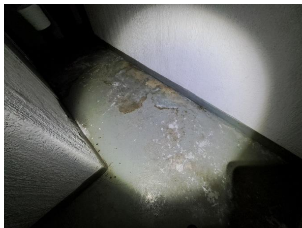
Kuva 17. Kellarissa siellä täällä kosteusjälkiä.
