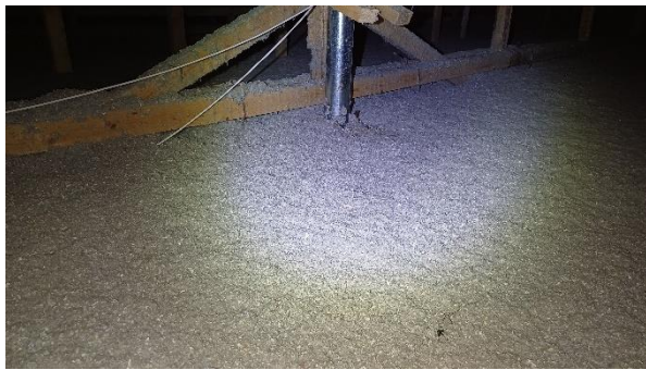
Kuva 53. Luukkasiiven antennin jalan kohdalla pieni kosteusvaurioalue
