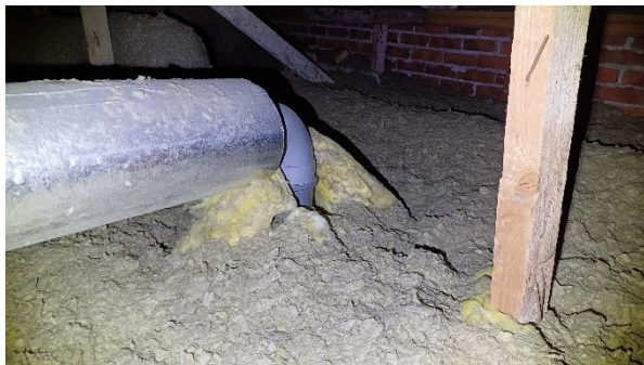
Kuva 55. Ruokalan yläpuolisessa yläpohjatilassa viemärin tuuletusputki lämmöneristetty puutteellisesti
