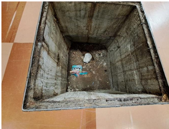
Kuva 18. Ruokalasiiven aulassa tekniikkaluukku, joka on epätiivis. Pohjalla kosteutta.
