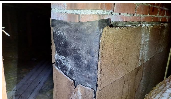
Kuva 59. Liikuntasalin yläpuolisen yläpohjatilan rakenteissa silminnähtäviä kosteusvauriojälkiä
