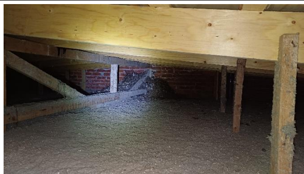
Kuva 52. Luokkasiiven yläpohjatilassa iso linnunpesä
