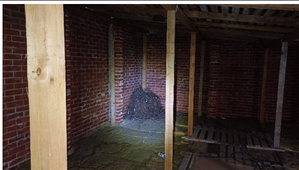
Kuva 57. Liikuntasalin yläpuolisessa yläpohjatilassa isohko linunpesä
