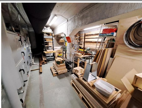
Kuva 14. Teknisen työn takavarastossa on maanvarainen betonilaatta ilman alapuolista lämmöneristettä.
