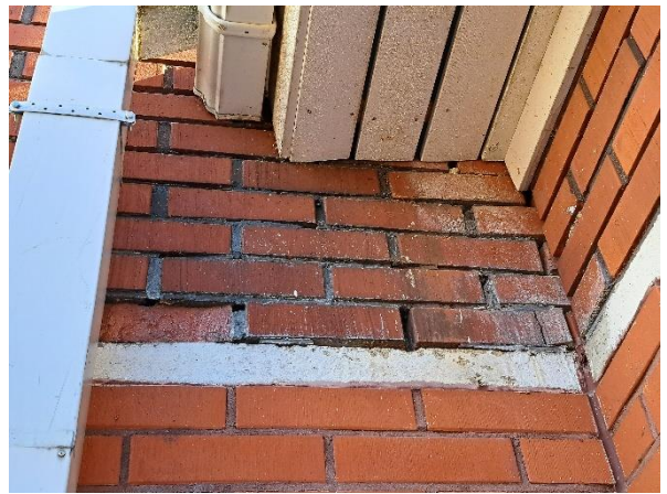
Kuva 36. Teknisen työn päädyssä on jäätyksen aiheuttamaa rapaumaa.
